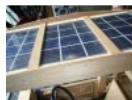
太陽光パネル
